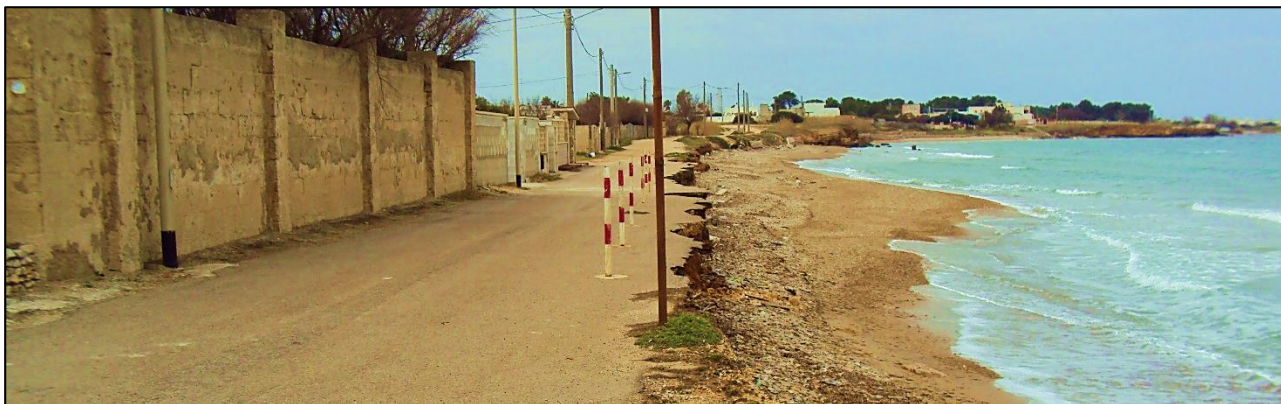
Figura 9 – Infrastruttura stradale direttamente interessata dall'erosione operata dal moto ondoso per assenza di spiaggia al piede.
